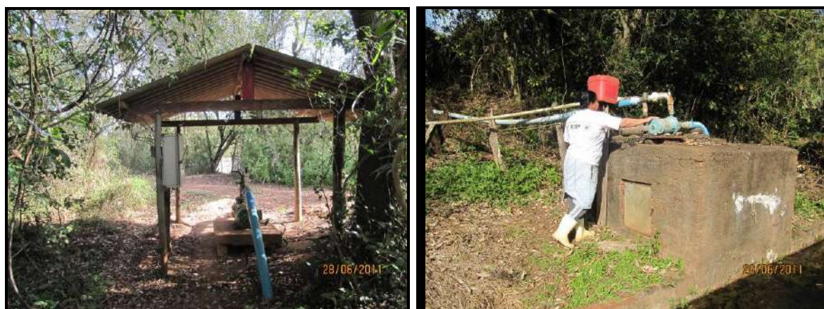
Figura 208 – Mecanismos elétricos de bombeamento da água em fazenda na ADA.
