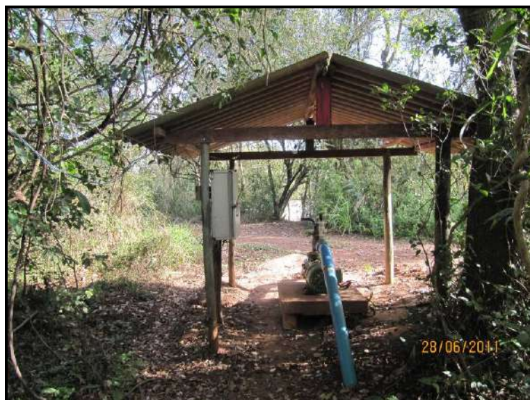
Figura 276 – Casa de força para bombeamento da irrigação
